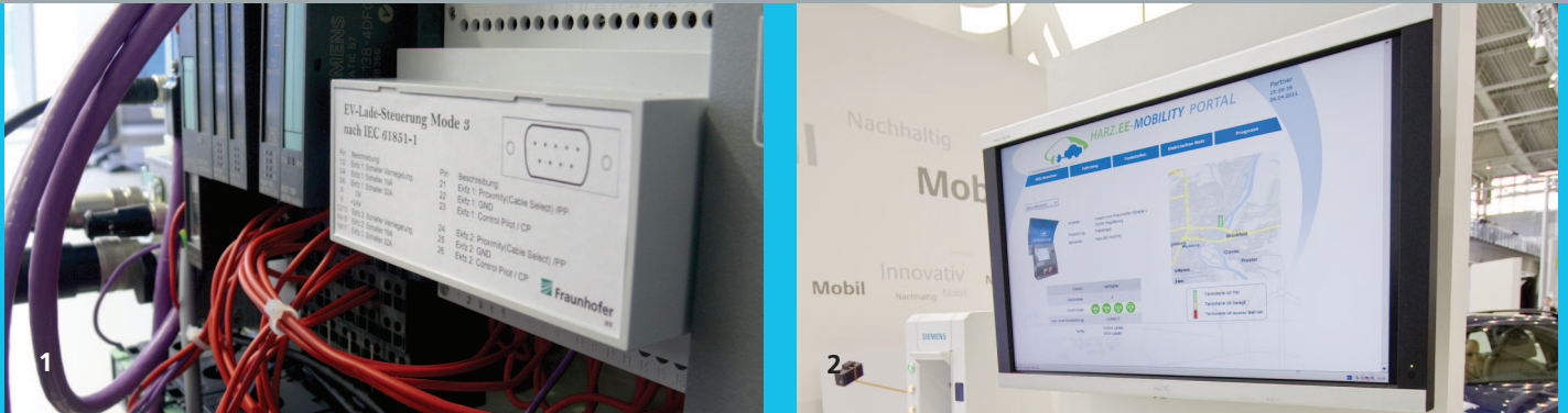
1 IKT-Komponente in einer Ladestation für Elektrofahrzeuge.
